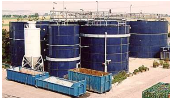
Очистные сооружения, производство фруктовых соков Wesker, Айслебен, Германия
